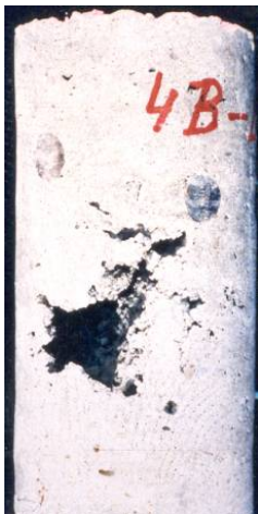
Bild 15: Spritzschatten hinter Stahlarmerung
